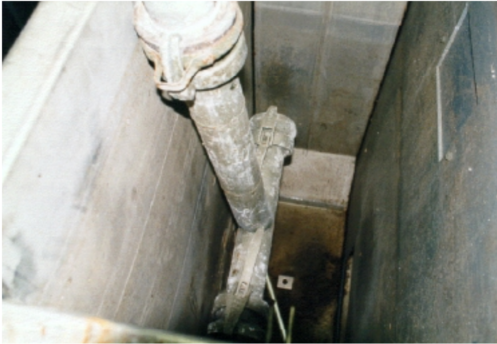
Auslauf des Rohrflockers in das Becken
